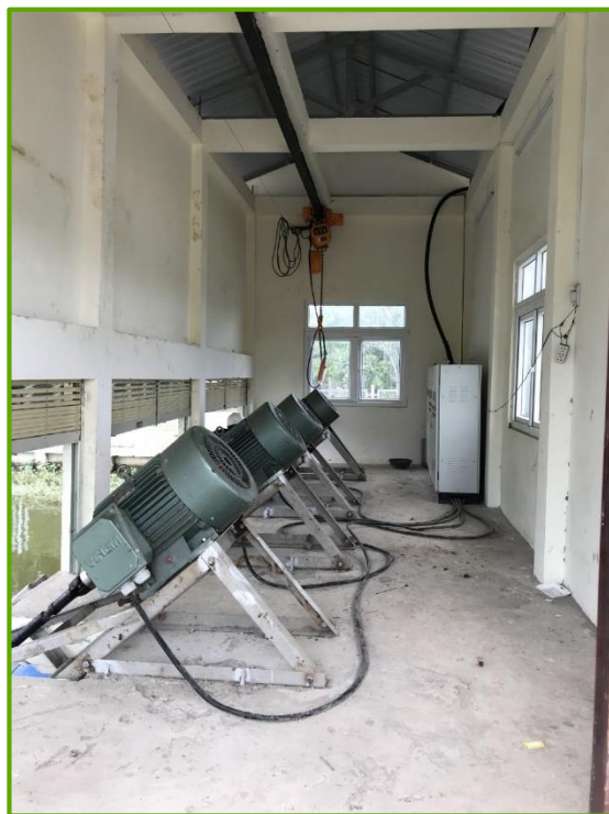
Dự án: Trạm bơm Rạch Bào Địa chỉ: Huyện Trần Văn Thời – TP Cà Mau Chủ đầu tư: Chi cục Thủy lợi Hạng mục: 4 tổ bơm TN2500-3
